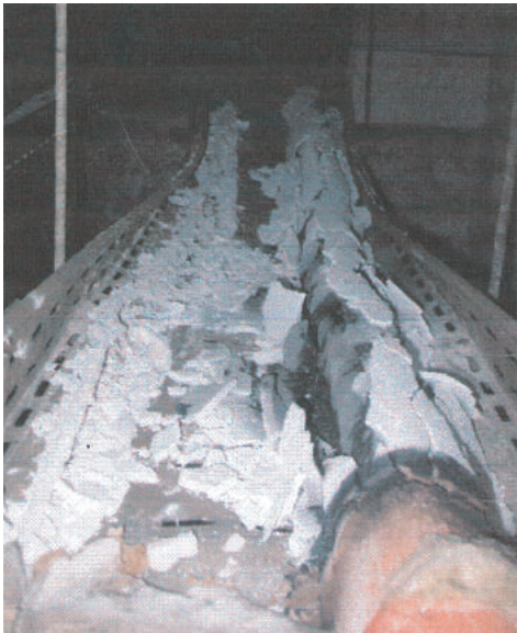
Вид кабельных линий после испытаний
